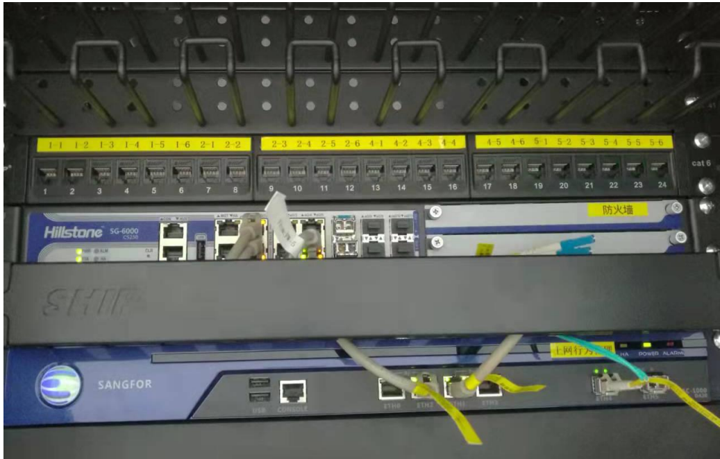
图 2 出口防火墙（山石万兆防火墙）
